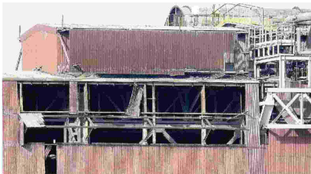
Lo stato di degrado in cui versano alcuni impianti della ex Lucchini (FOTO PABAR)
